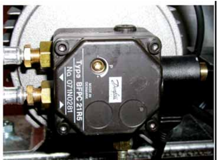
FOTO 3: particolare pompa gasolio
