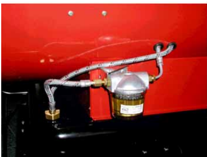
FOTO 2: détail groupe filtro gasolio
