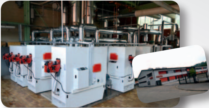
▲ Lieu d'installation: Usines "AGRIA" / Möckmühl
