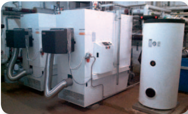
▲ Lieu d'installation: Garage Mercedes / Singen
