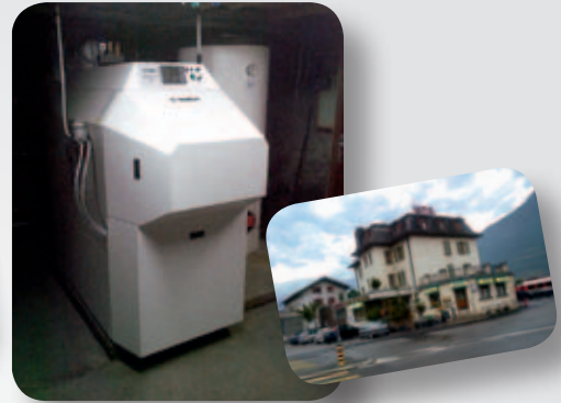
▲ Lieu d'installation: Hotel Martigny / Wallis (CH)
