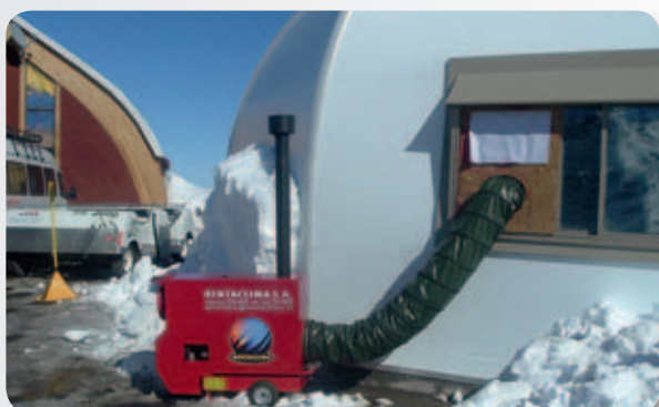
▲ Lieu d'installation: Valle Nevado / Santiago de Chile
