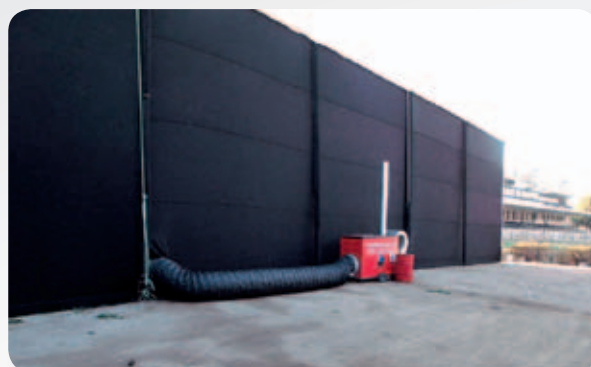
▲ Lieu d'installation: Evento Hipodromo / Santiago de Chile
