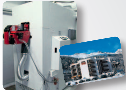
▲ Lieu d'installation: Hotel San Gian / St.Moritz (CH)
