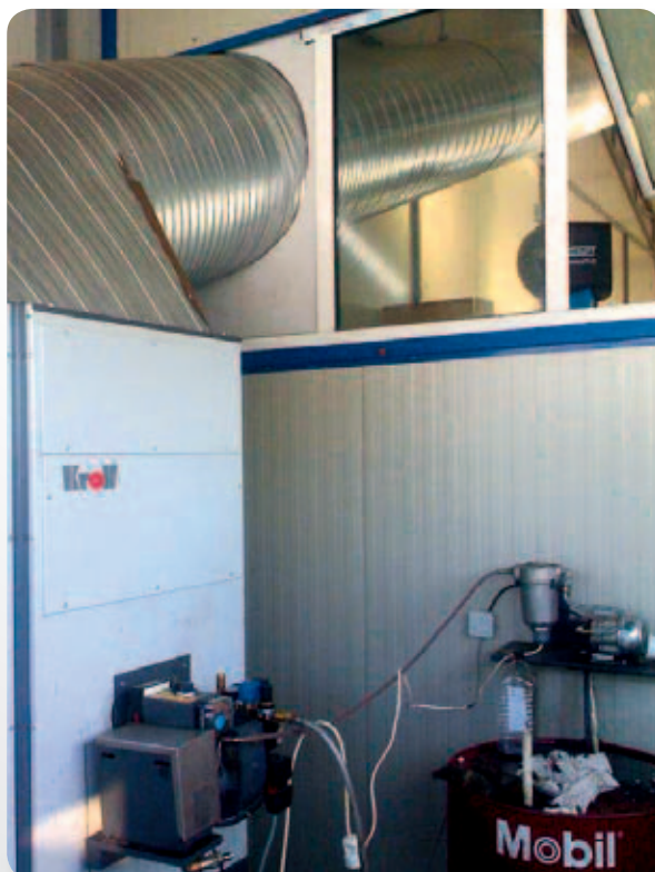
▲ Lieu d'installation: Hall d'exposition garage Škoda / Roumanie
