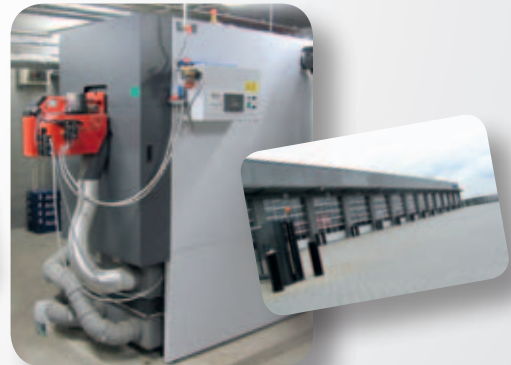
▲ Lieu d'installation: Garage VOLVO / Bettembuorg (LUX)
