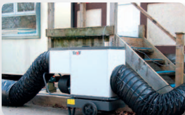
▲ Lieu d'installation: Ecole d'inondation à Farnham / Angleterre
