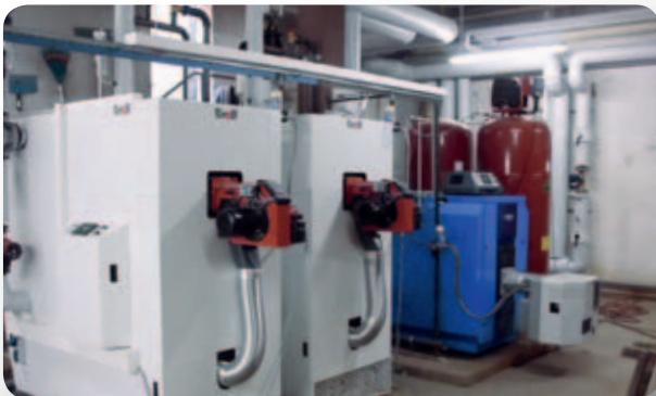
▲ Lieu d'installation: Ensemble des bâtiments à 144 logements / Wildberg, Forêt Noire
