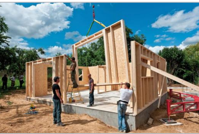
Une cinquantaine de maisons ossature bois ont été produites en 2011. (Photo DR)
